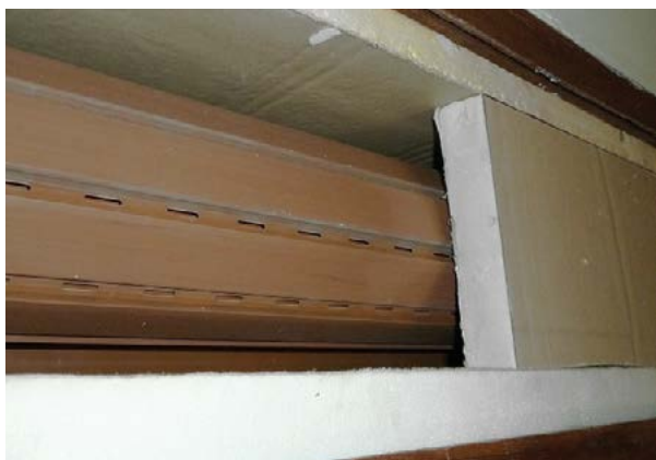
Dämmung des Rollladenkastens an allen Seiten
