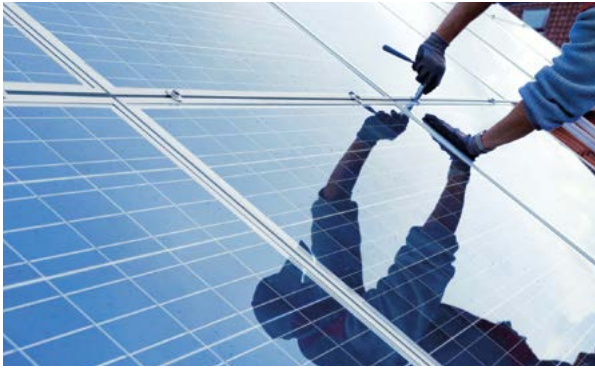
Steildach mit integrierter Fotovoltaikanlage
