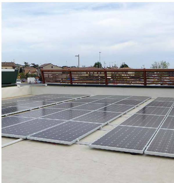
In ein Cool-Roof-System installierte Fotovoltaikmodule. Das Cool Roof ist stark reflektierend, wodurch die Oberflächentemperatur des Dachs und der Wärmeinseleffekt reduziert werden.
