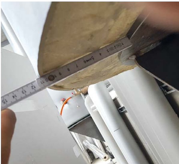
Dämmung des Boilers (Warmwasserspeicher)
