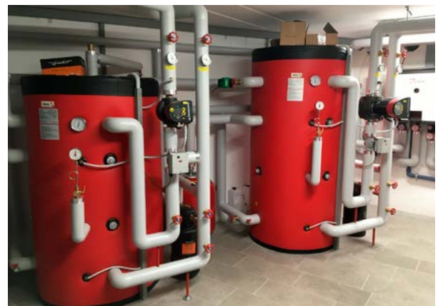
Technikraum mit isolierten Rohrleitungen
