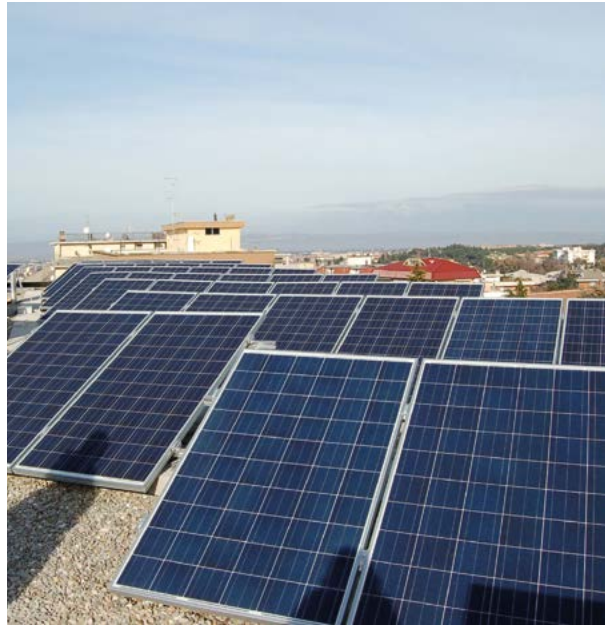
Flachdach mit monokristallinen Siliziummodulen
