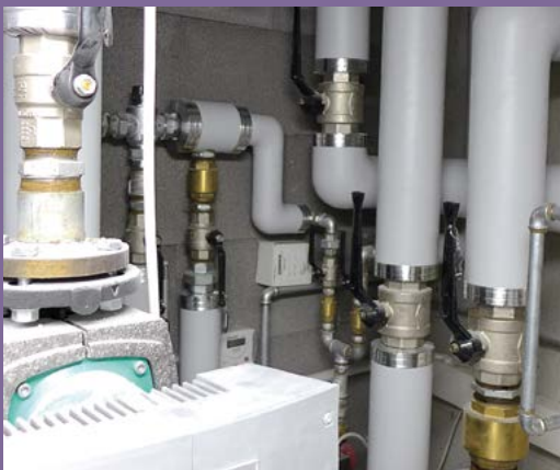
Heizungsnetz mit gedämmten Rohrleitungen
